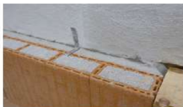
Realizzazione dell'ancoraggio della controparete alla parete esistente ogni 3 corsi in altezza a distanza orizzontale di 1,5 m*
